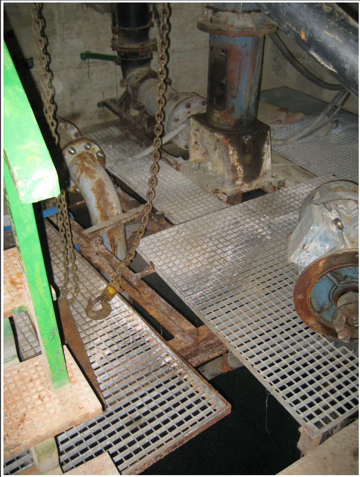
Interior de la caseta del pozo en el camino del Matadero 2 (18/10/2006)
