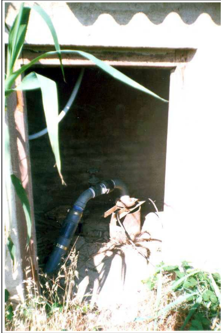
VISTA DEL SONDEO Y TUBERÍA DE IMPULSIÓN (29/06/1999)
