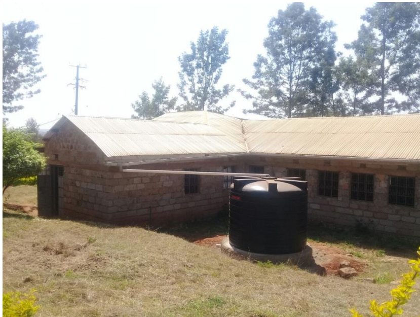
Maternidad de Mihango sin terminar debido a la falta de agua
