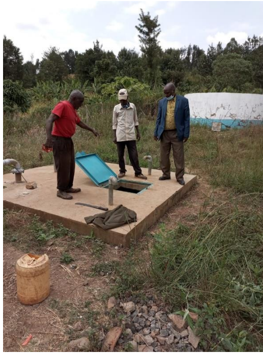
Depósito subterráneo de hormigón de 20 m 3 para alimentar la bomba
