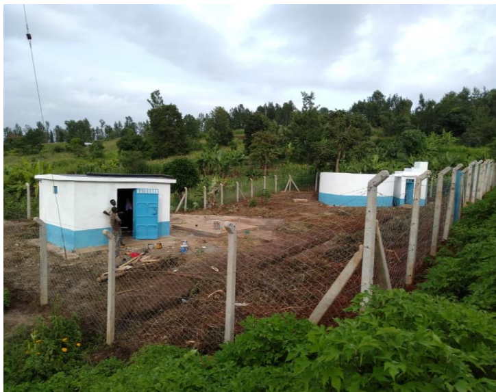
Imagen de la estación de bombeo, planta de tratamiento de agua y vallado
